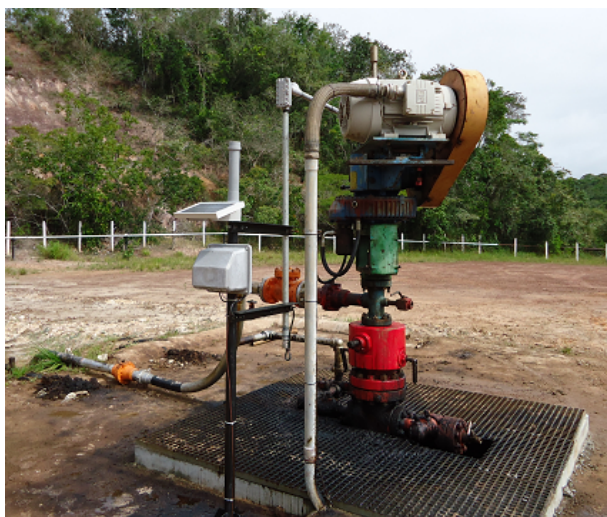
Figura 10 - Controlador WSI270 instalado em poço BCP
