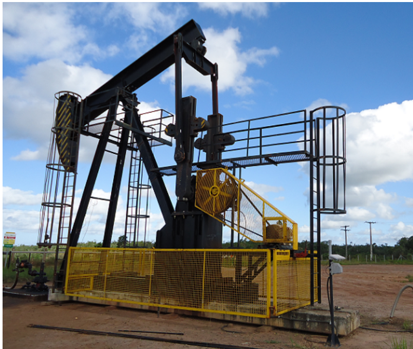
Figura 6 - Controlador WSI270 instalado em poço de bombeio mecânico
