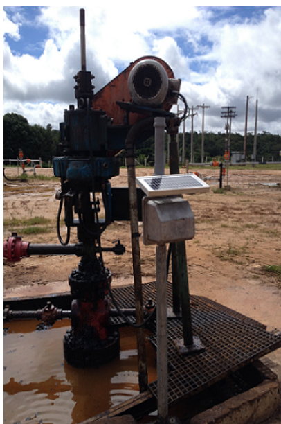
Figura 15 – Exemplo de Controlador WSI270 instalado em poço BCP
