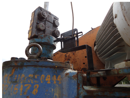
Figura 9 - Sensor Hall instalado na haste do poço BCP
