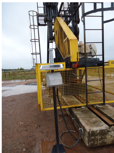
Figura 7 - Detalhe do Controlador WSI270 instalado em poço de bombeio mecânico
