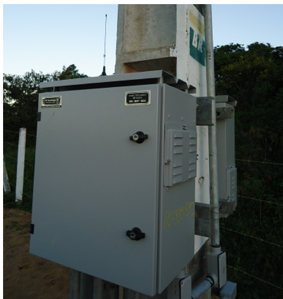
Figura 2 - Painel de Comando ACOS 216 da HI Tecnologia
