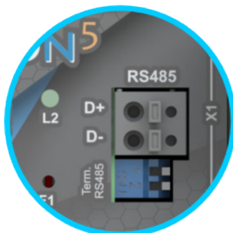
Borne de conexão dos sinais da RS485.
